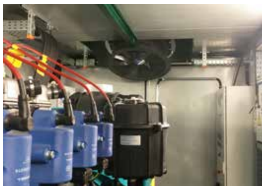
Ventilatore Ziehl-Abegg EC serie ZAprus ad altissima efficienza all'interno del vano macchine di un impianto biogas
